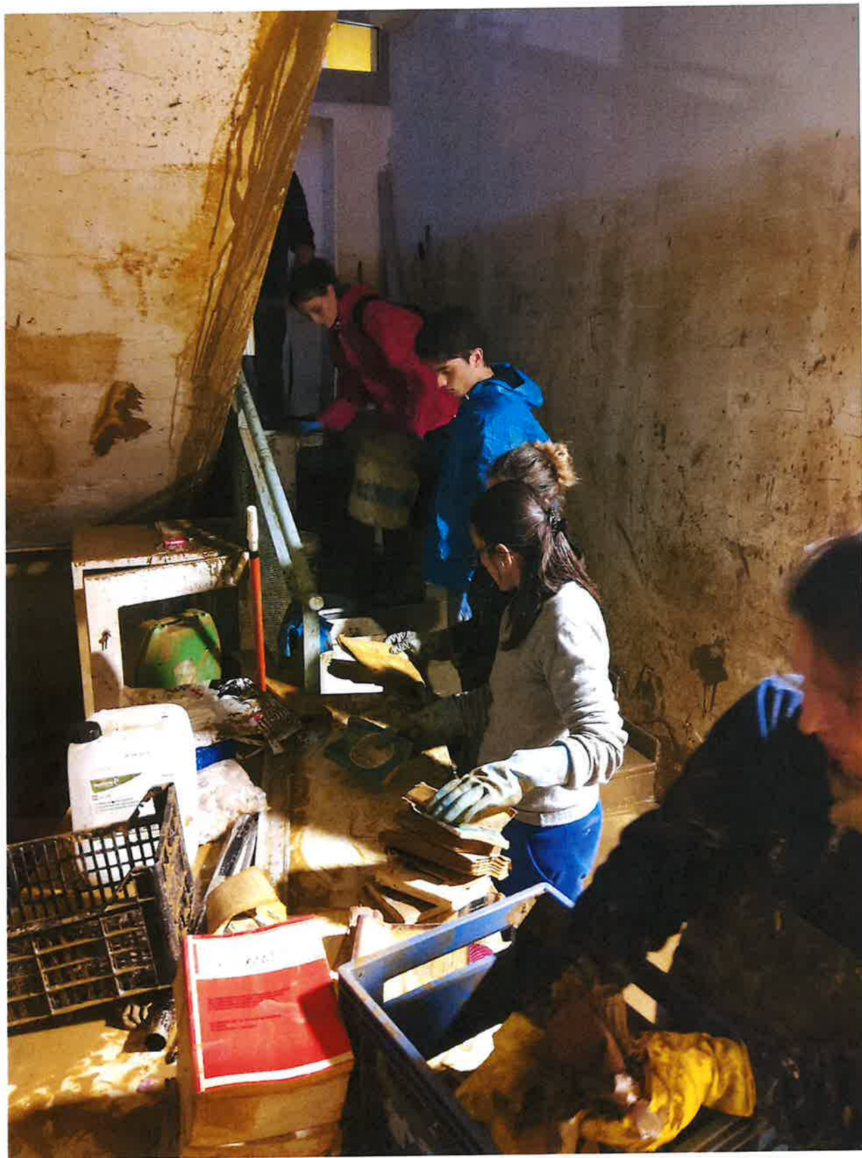
Fig. 7: sgombero dell'accesso al deposito, pomeriggio 4/11/2023
