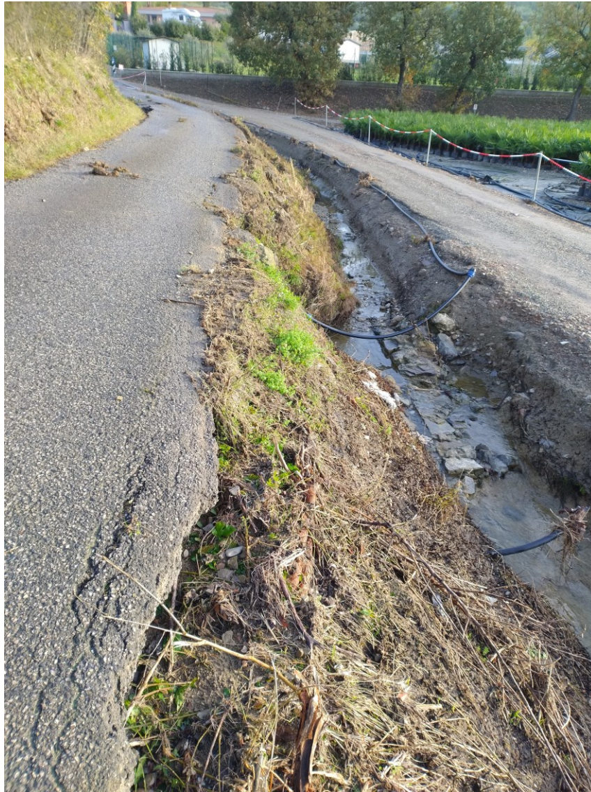
FOTO 1. CEDIMENTO DELLA SPONDA
