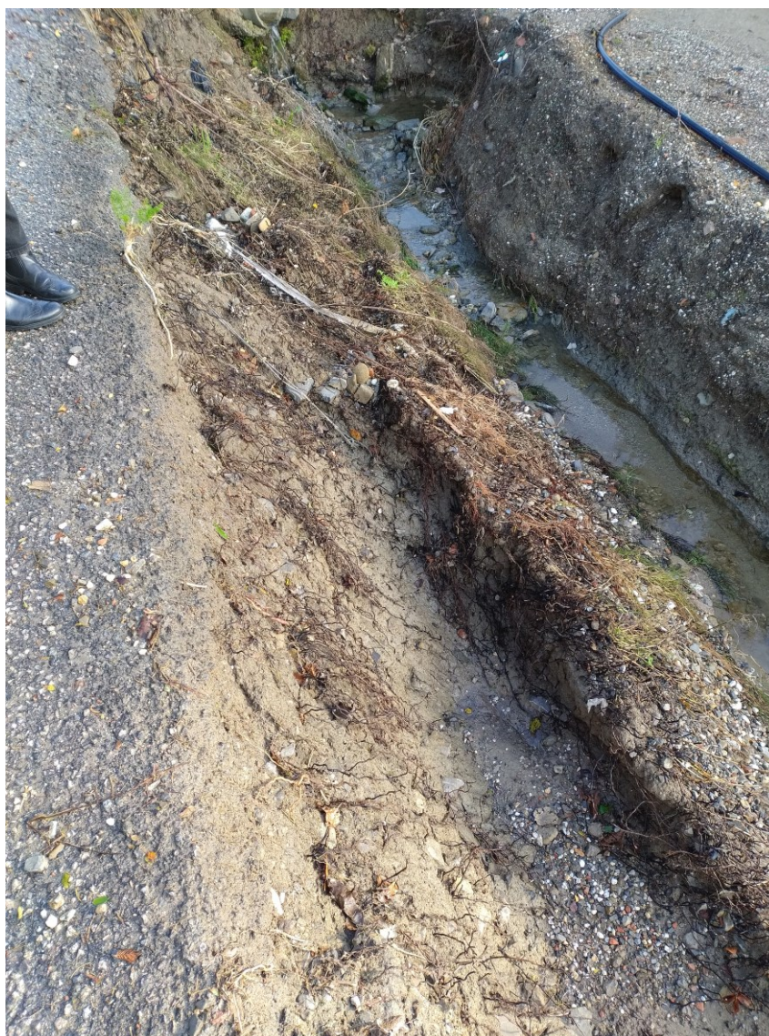
FOTO 3. CEDIMENTO DELLA SPONDA
