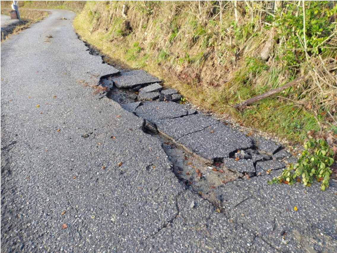
FOTO 2. TRATTO DI ASFALTO DANNEGGIATO
